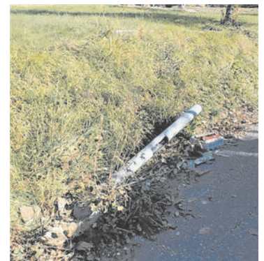
▲ Die Straßenlaterne muss erneuert werden. Foto: Klement
